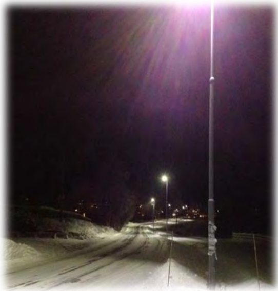
Lysarmaturene byttes slik at en kan bruke LED-pærer.
